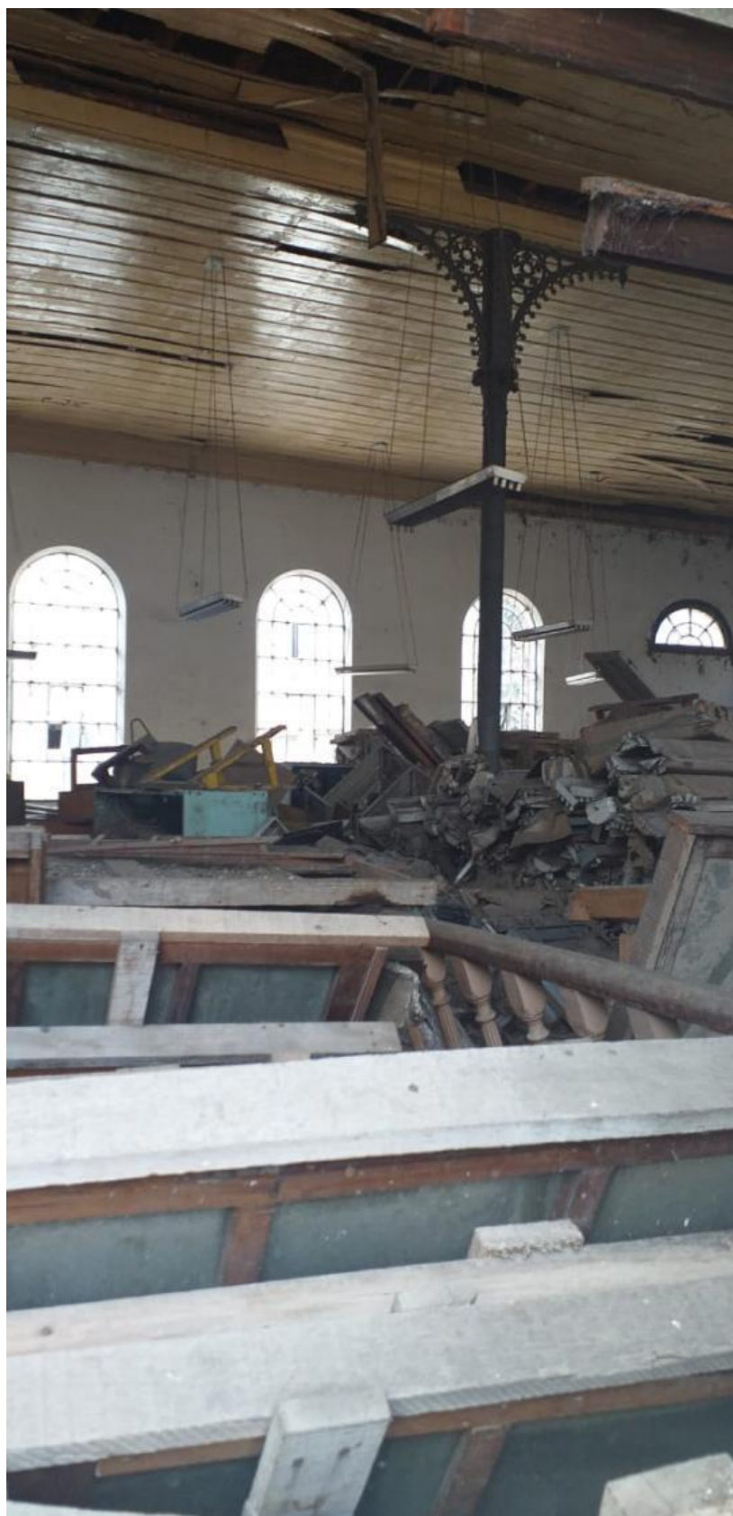
Figura 25: Parte interna de um dos armazéns e sua deterioração. Foto do autor. 25 janeiro 2021.
